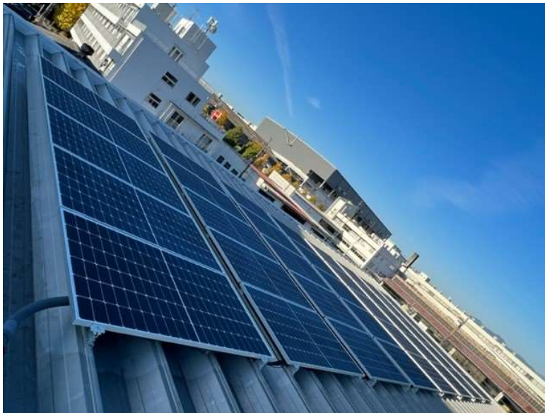
太陽光発電設備 15.40kW
